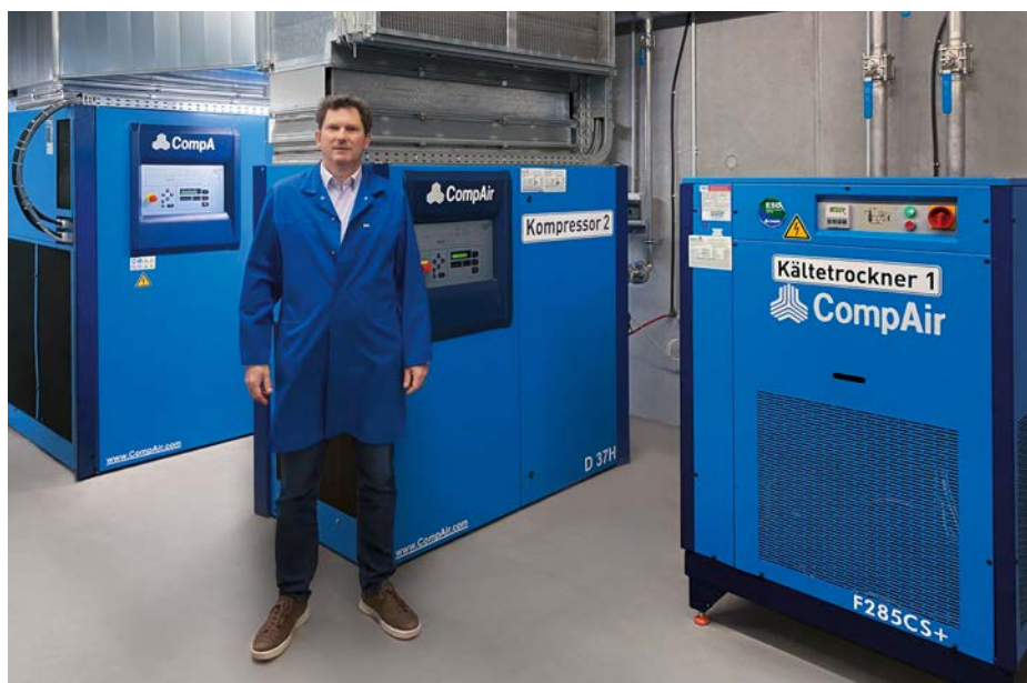
Abb. 2: „Mit der PureAir-Technologie von Compair können wir die Life-Cycle-Kosten der Druckluftherzeugung deutlich reduzieren. Die Anlage und die gesamte Station arbeiten zuverlässig und mit hohem Wirkungsgrad“, so Marco Erdtmann, Werksleiter bei Pano.
